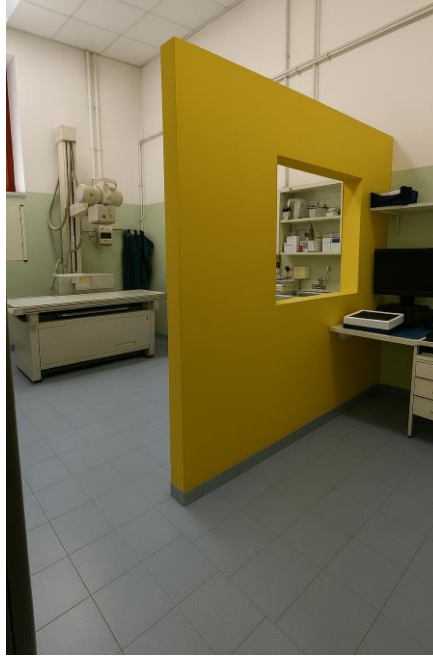
Figura 58. Schermatura di piombo in muratura e vetro piombato presente all'interno della sala radiologica PA.
